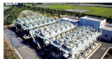
下水の高度処理施設
